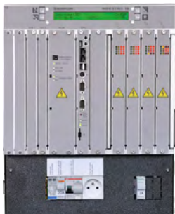
Rack M@ESTRO et servitudes
